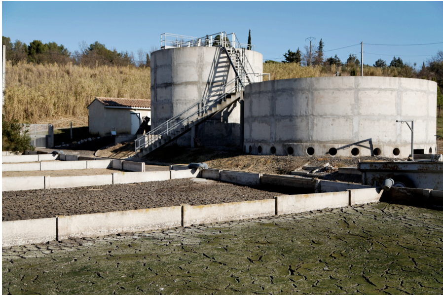
Le projet initial, copie conforme de la station de ST PARGOIRE, tel qu'il aurait été intégré dans le paysage. Le portail dans la photo du haut donne l'échelle.
